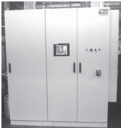
Рис. 1. Шкаф управления установкой
