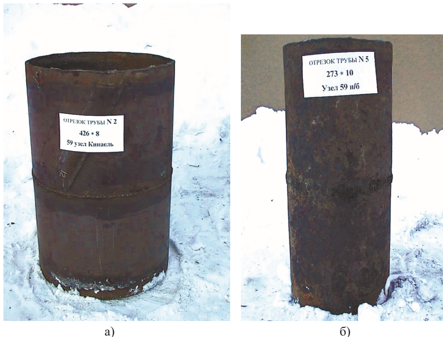
Рис. 1.5. Катушки из газопровода надземной прокладки Ухта – Войвож, подверженные сплошной коррозии:
