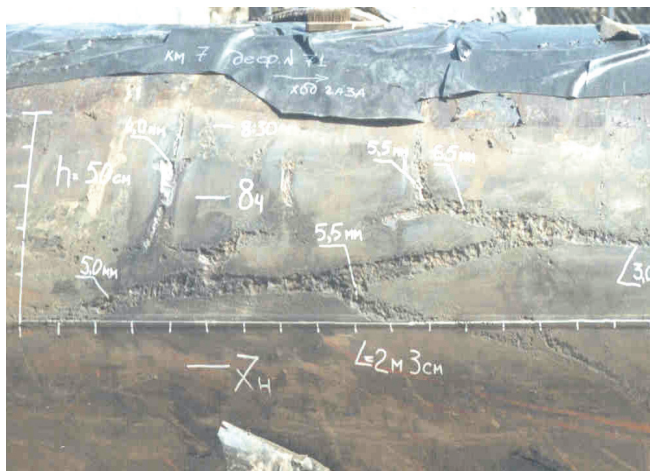
Рис. 1.2. Характерный вид коррозионных повреждений магистрального длительного эксплуатируемого подземного трубопровода
