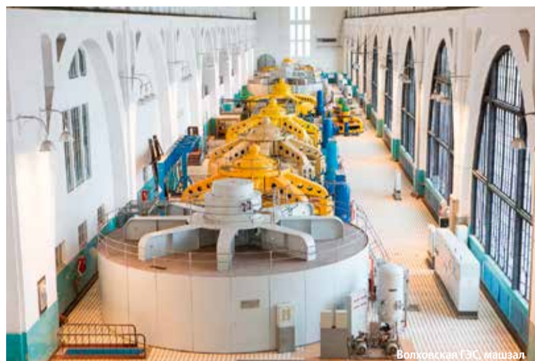
Волховская ГЭС, машзал
