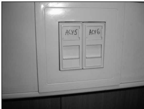
Рис. 1.6. Гнезда розеток, закрытые заслонками
