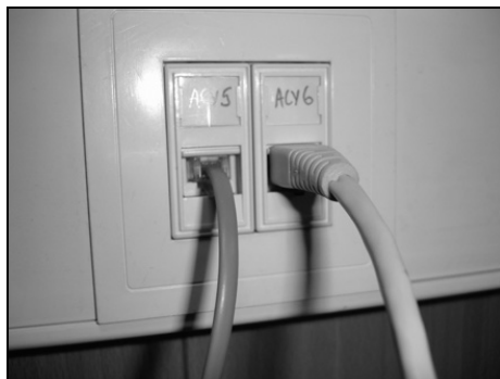
Рис. 1.5. Телефонный и компьютерный кабели подключены в одинаковые гнезда
