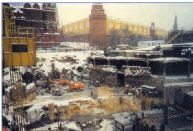
Завершение земляных работ в котловане строительства комплекса на Манежной площади в Москве
