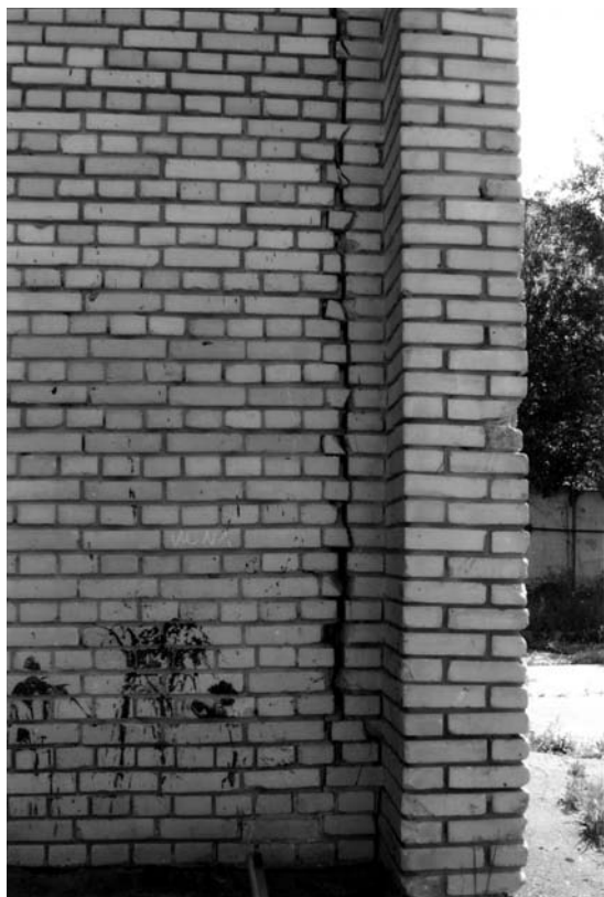
Рис. 1.3. Образование сквозных трещин в стенах от пучения грунта
