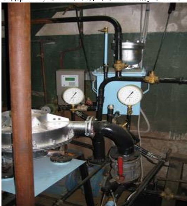
Рис. 1. Установка волнового диспергатора БРАВО в мазутном хозяйстве котельной
