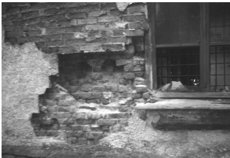
Рис. 1. Разрушение кирпичных стен здания от размораживания кладки
